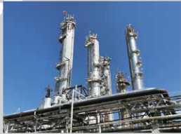
Diamond Petrochemicals Canada Corporation (DPCC) ブタジエン製造 (カナダ)
