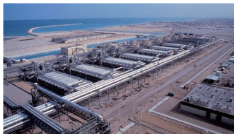
海水淡水化プラント
